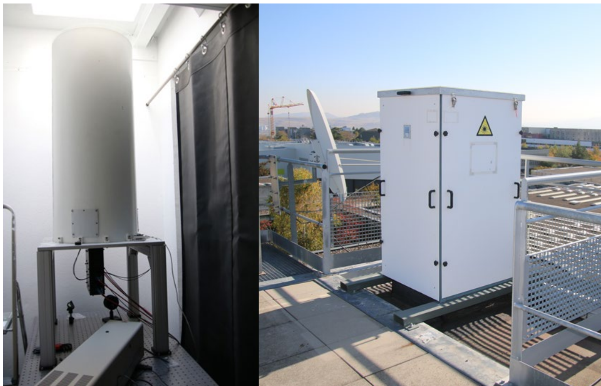
Figure A2. Photographies du système lidar à l'intérieur du bâtiment (à gauche) et la nouvelle ouverture sur le toit où a été placé l'ancien caisson (à droite), suite aux évolutions dans le cadre du projet COPLid.
